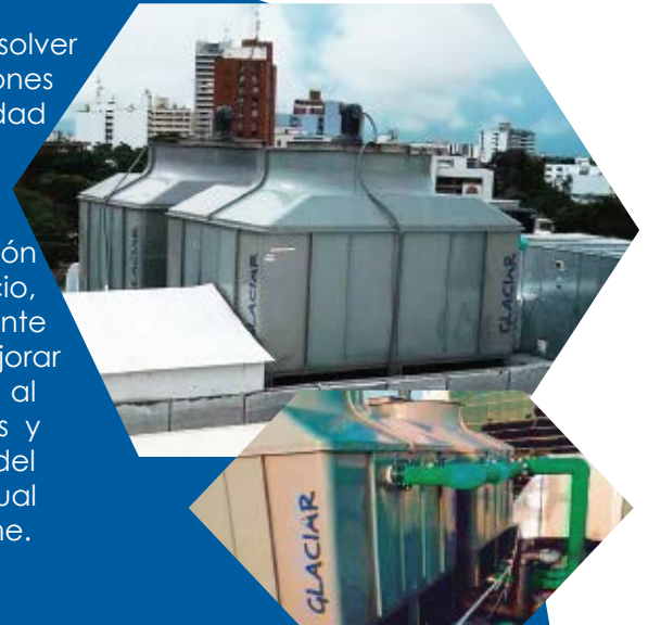
Torres de enfriamiento
