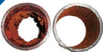
Sección del mismo tubo después de aproximadamente 12 meses de instalado el sistema Bauer.
