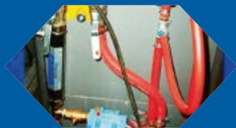
Chiller en industria
